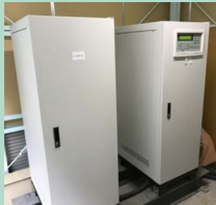
屋内型30kwバッテリーユニット
