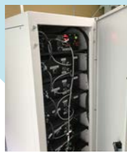
30kwバッテリーユニット
