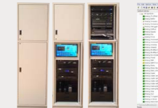
AV機器収納ラック(特注)
