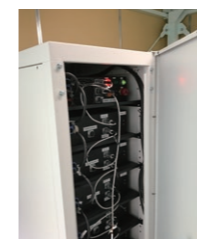
30kw/バッテリーシステム
