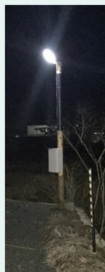
駐車場への設置
