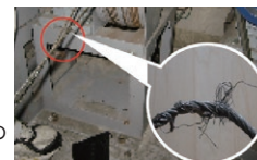
バトン昇降装置のワイヤー破損
